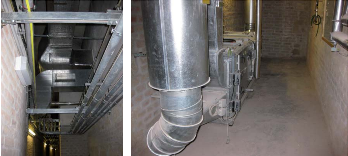
Abb. B.91: Die Klimaanlage für die Sonderdepots des MVK entnimmt dem Keller bis zu 7.000 m 3 Luft.
