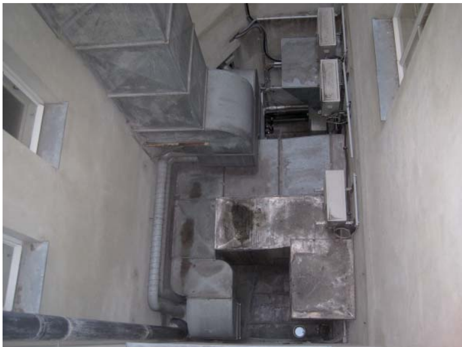
Abb. B.51: Klimageräte im Lichthof E der Neuen Burg. Abwärme und Lärm verhindern für die anderen Anrainer ein adäquates Lüftungsverhalten.
