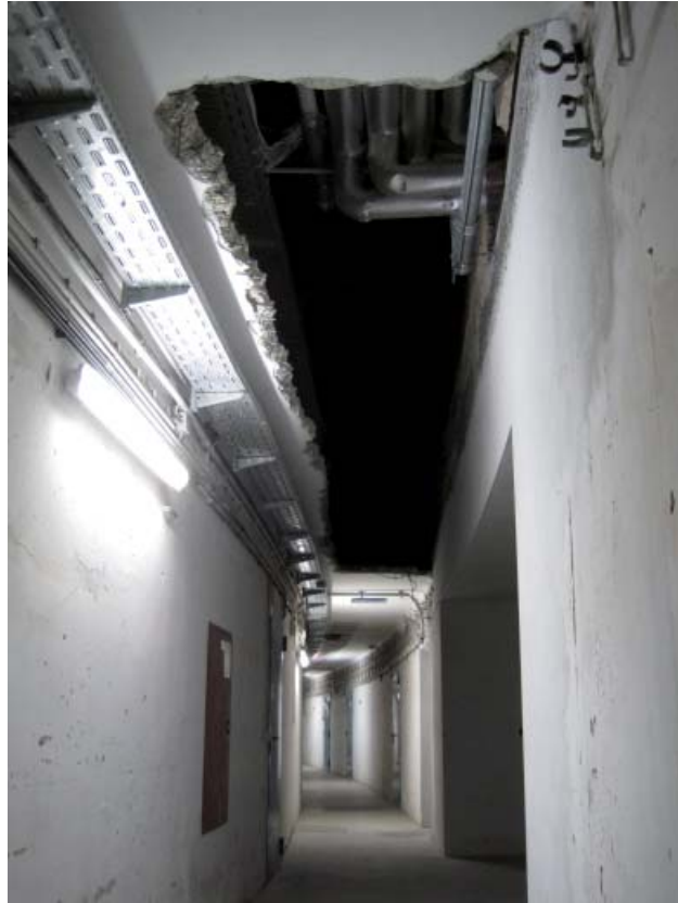
Abb. B.75: Eingriff in den horizontalen Hauptkollektor im Segmentbogen im 2. Keller (H-Stiege)
