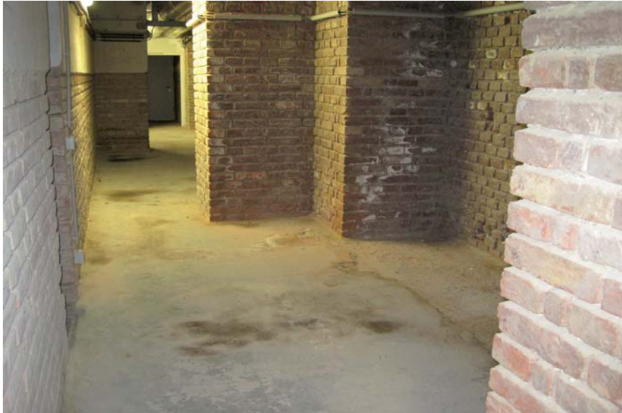
Abb. B.31: Bei hoher Außenfeuchte kondensiert im Sommer Wasserdampf an den kühlen Wand- und Bodenflächen.
