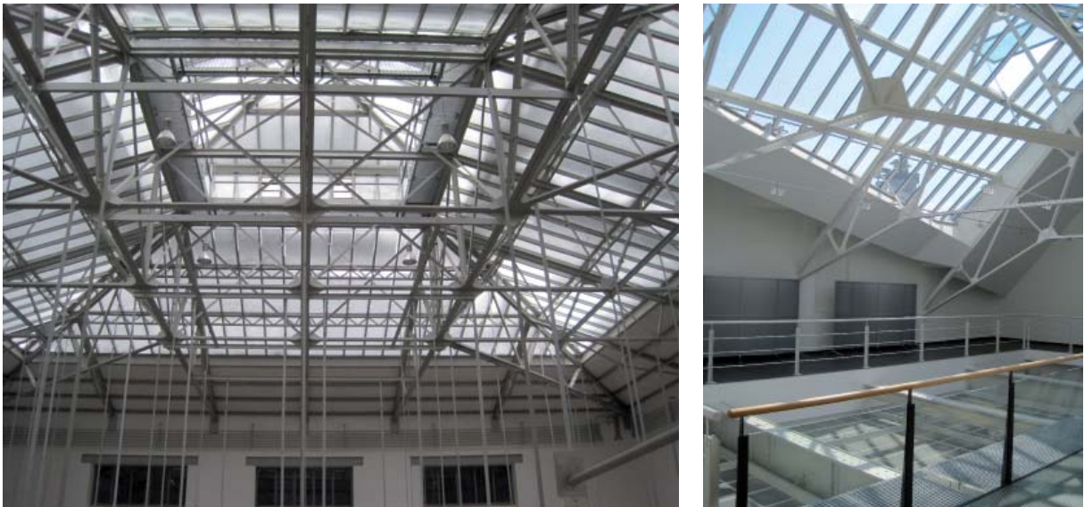
Abb. B.109: Über die mit transparenter Isolierverglasung ausgestatteten Lichtdächer findet ein hoher solarer Strahlungseintrag in den Gebäudekern statt. Die Wärmeabfuhr durch konvektive Entlüftung ist nahezu wirkungslos. Links: Glaspypamide über der Säulenhalle des Corps de Logis. Rechts: Glasdach zur Belichtung des Franz-Saales im Bildarchiv der ÖNB
