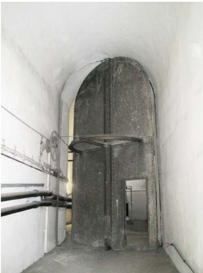
Abb. A.6: Drehtür am Beginn des Lufteinlasses des Burgtheaters
