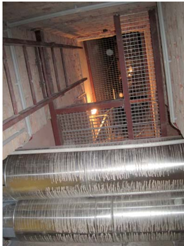
Abb. B.39: Fernwärmerohr am Fußpunkt von Schacht A
