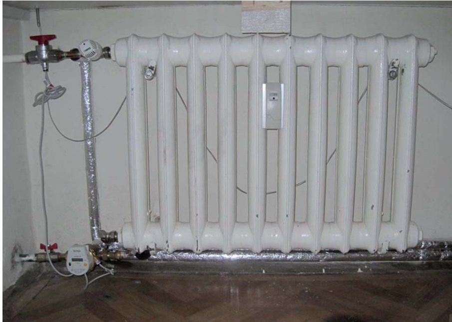
Abb. C.27: Zwei Radiatoren im unteren Werkstattraum wurden parallel geschaltet und mittels Wärmemengenzähler ihr Gesamtverbrauch ermittelt.
