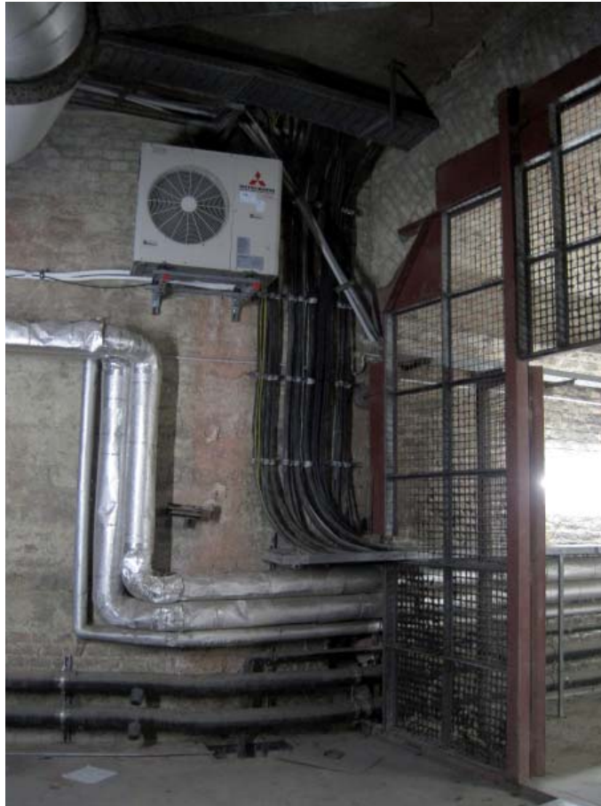
Abb. B.52: Im Sommer 2010 entdeckter Wärmetauscher (11 kW) im 2. Keller. Die Abwärme wird kurz vor der geplanten Zuluftansaugung zur Belüftung der SAM in den Hauptzuluft-Tunnel geblasen.
