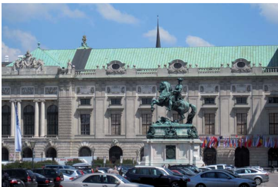
Abb. C.47: Die Kupferdächer zeigen im erneuerten Bereich signifikante Farbabweichungen
