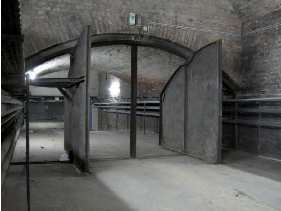
Abb. B.15: Doppeldrehtür im Lufteinlass zum 2. Keller
