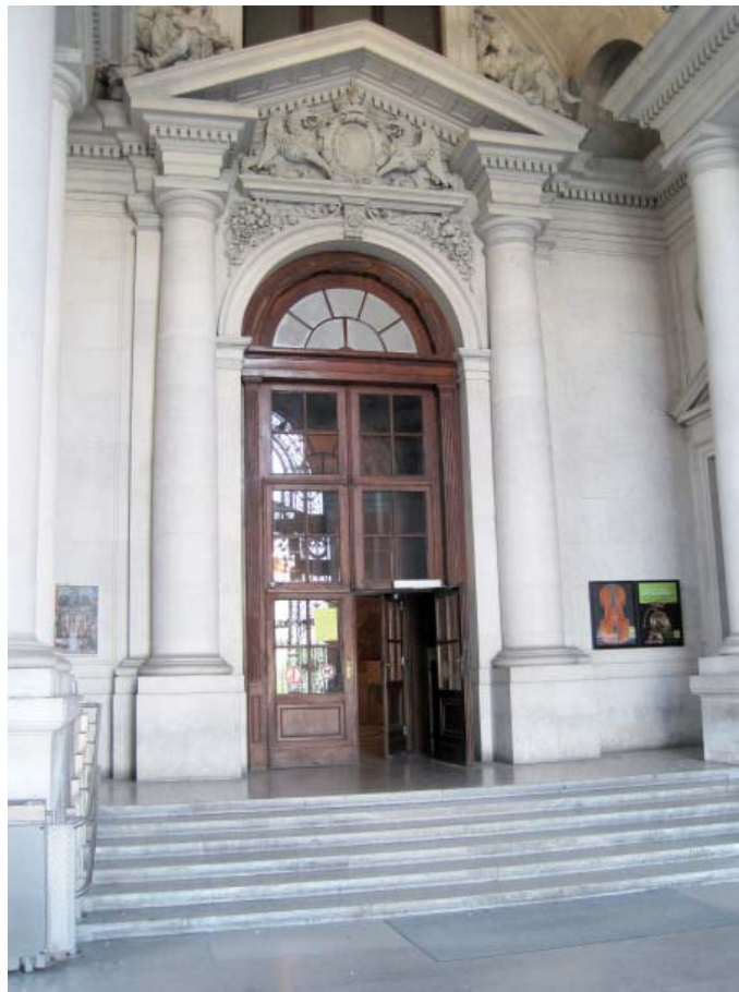
Abb. B.80: Haupteingang in die Neue Burg: Aufgrund der Türautomatik bzw. durch Aufkeilen der Türen im Sommer ist die Funktion als Klimaschleuse nicht gegeben
