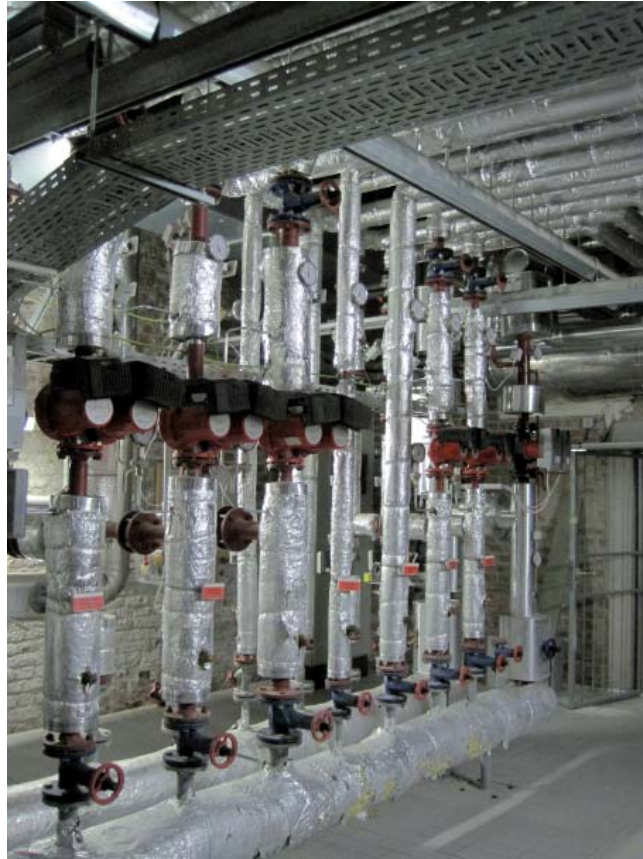
Abb. B.40: Umformerstation in der Nordecke des Corps de Logis
