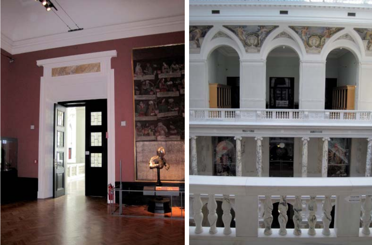
Abb. B.86: Die Türen zu den Galerien A - D verfügen über keine Türschließer und bilden keine funktionierenden Klimaabschnitte.
