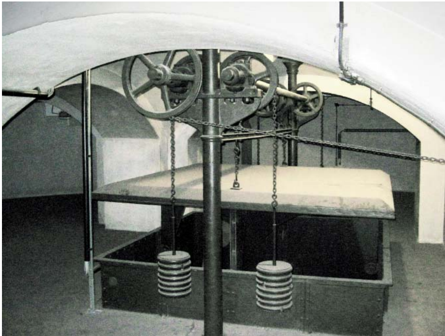
Abb. A.10: Mischkammer zur dosierten Zufuhr von Warmluft und Frischluft im Burgtheater
