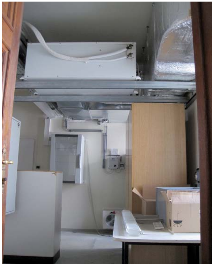
Abb. B.92: Zur Kühlung des Servers in der Sicherheitszentrale wird ein Gebläsekonvektor eingesetzt
