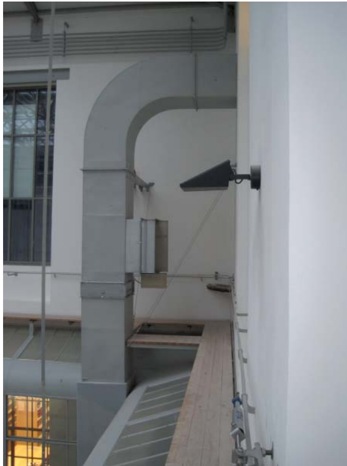
Abb. B.90: Der Dachraum oder wahlweise die Säulenhalle wird von zwei Ventilatoren mit einer Förderleistung von je 10.000 m 3 /h entlüftet.
