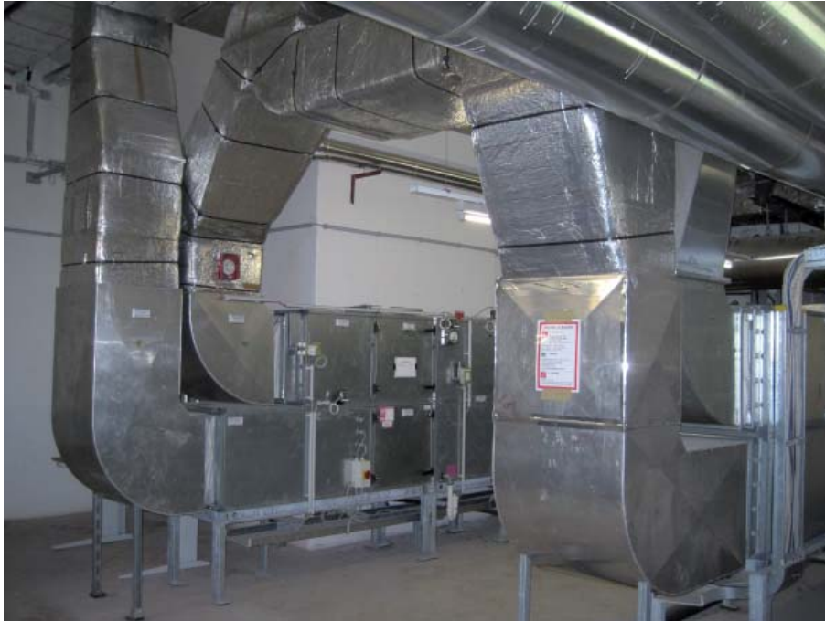
Abb. B.87: Eine der Lüftungszentralen im Mittelbau der Neuen Burg
