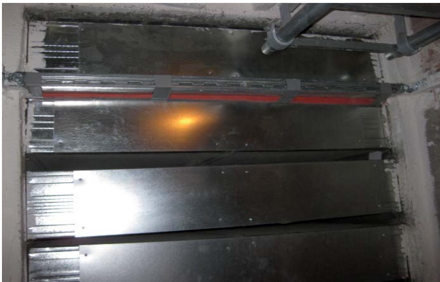
Abb. B.50: Die Abluftventilatoren der vier großen Lüftungsschächte sitzen direkt auf der Schachtmündung. Der Querschnitt des Schachtes wird von den Schalldämpfern um ca. 80 % vermindert und dadurch der freie Auftrieb behindert.
