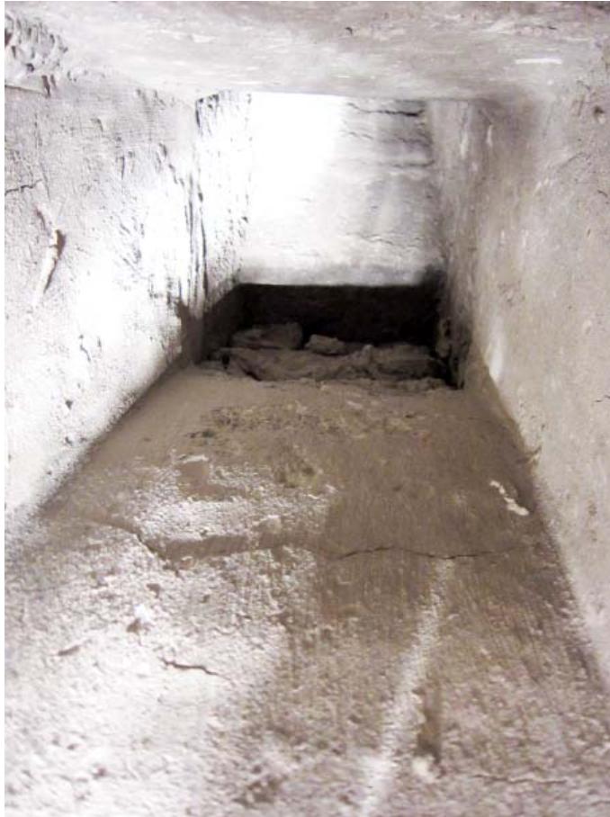
Abb. B.66: In Schacht Nr. 25 befindet sich ca. 50 cm über Fußbodenniveau eine zugemauerte Öffnung
