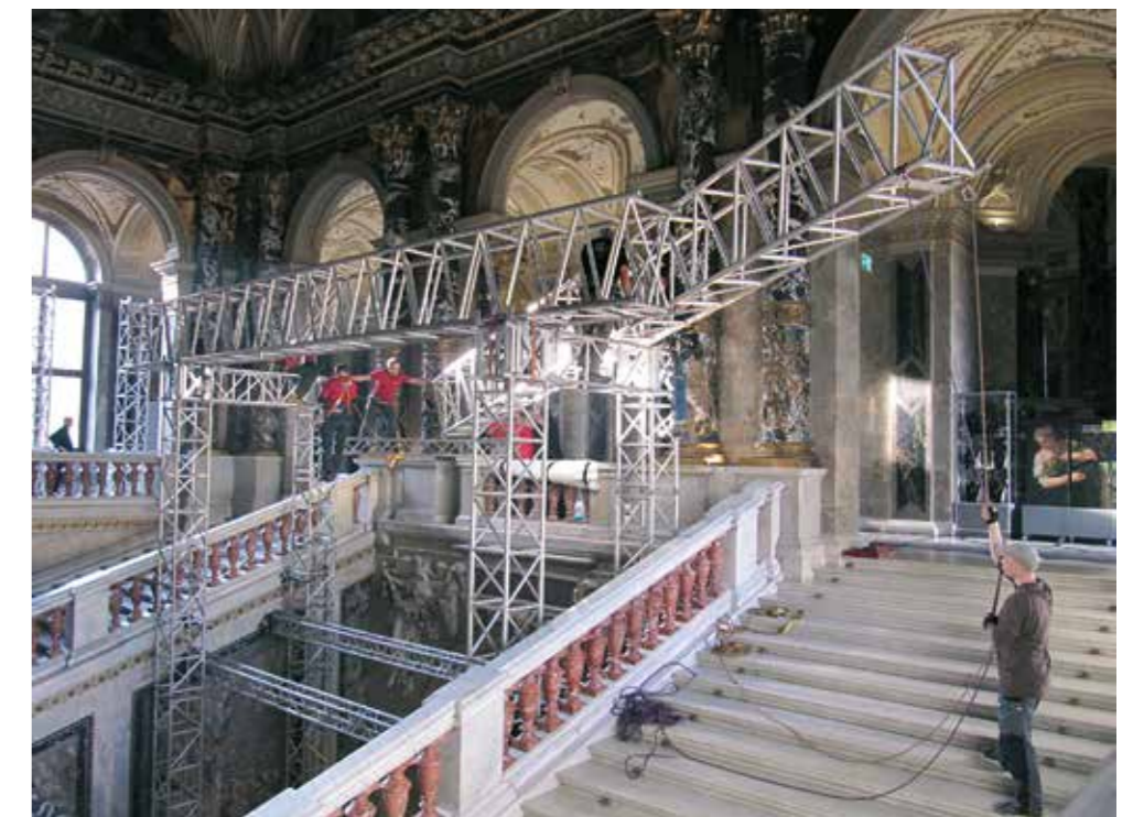
Aufbau der Brückenkonstruktion entlang der Nordseite des Stiegenhauses zur Sonderausstellung Gustav Klimt im Kunsthistorischen Museum
